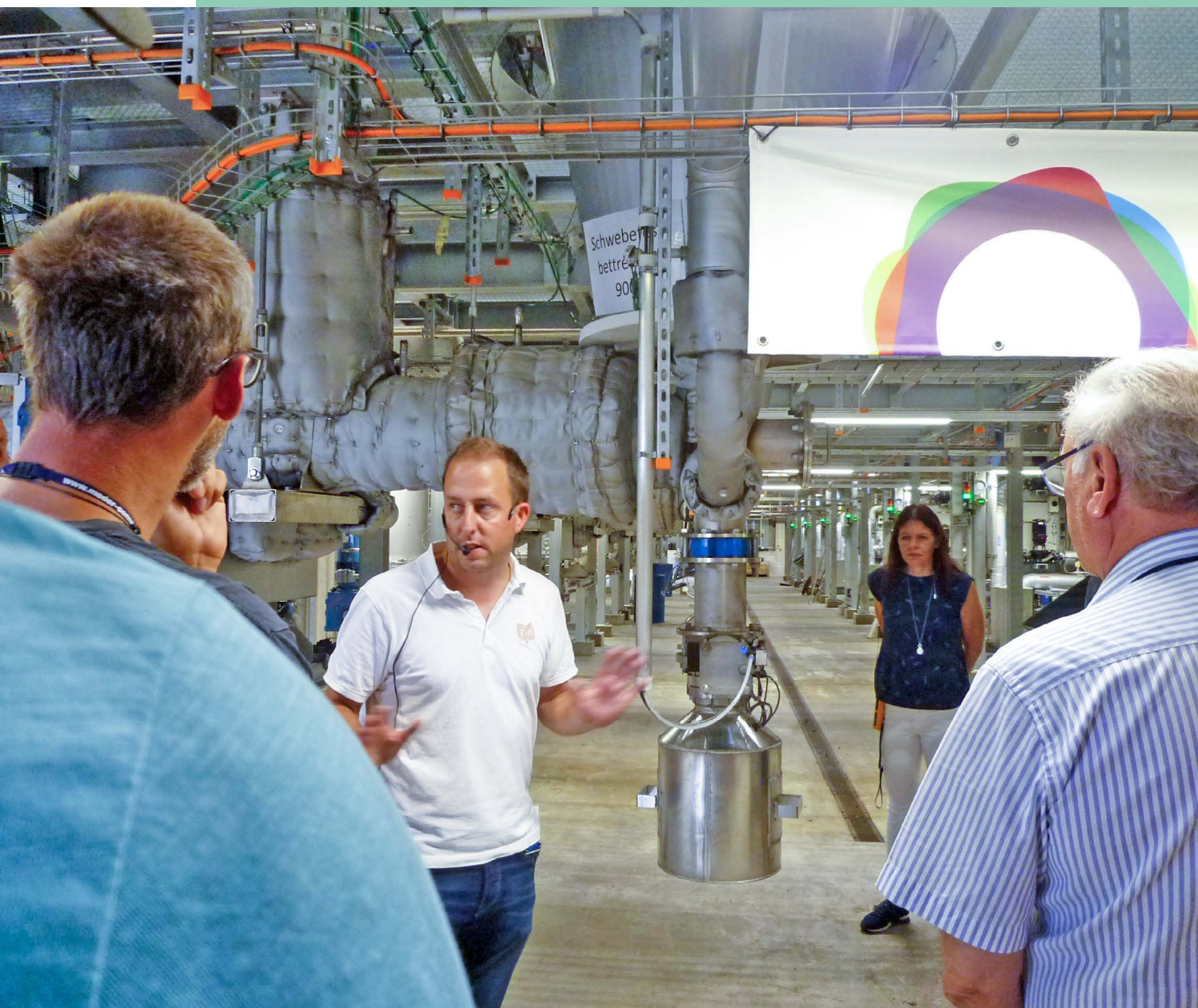
Stephan Ellenbroek erklärt den Schwebereaktor und den Pyrolysevorgang der Anlage.
